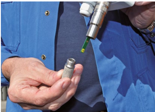
I hvert ventilationsanlæg er installeret følere som denne til at registrere den relative luftfugtighed, der er essentiel for styringen af ventilationen.
